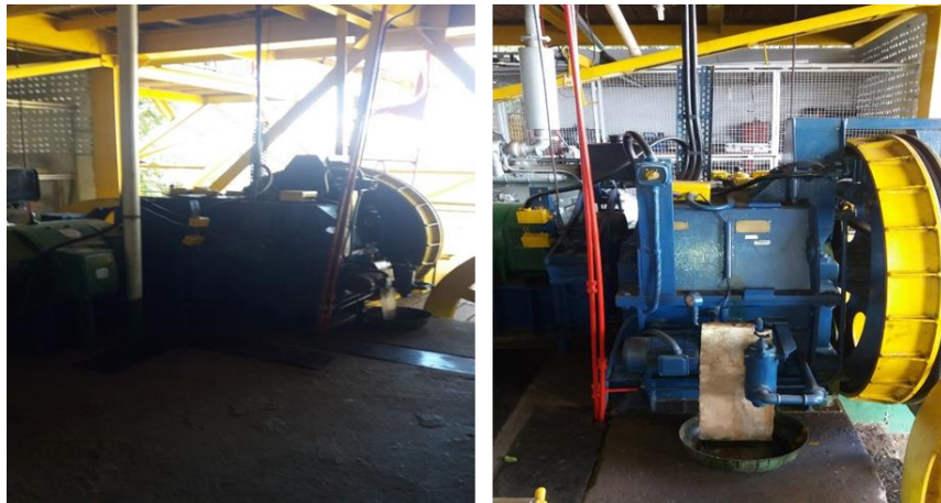
Sistema Motriz existente (a) Motor Elétrico/Principal e (b) Motor a Diesel/Reserva.
