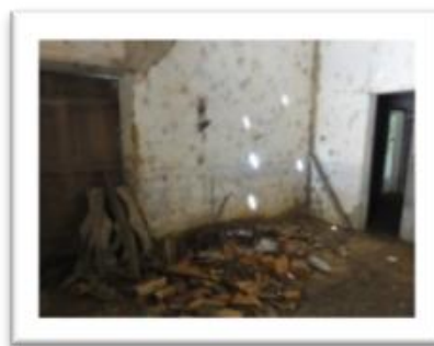
Figura 27. Estado de conservação do local
