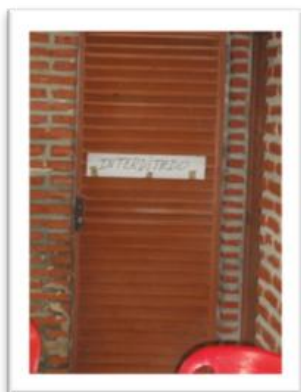
Figura 105. Sanitário interditado – lanchonete
